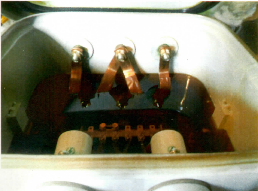
電灯トランス 30 kVA
